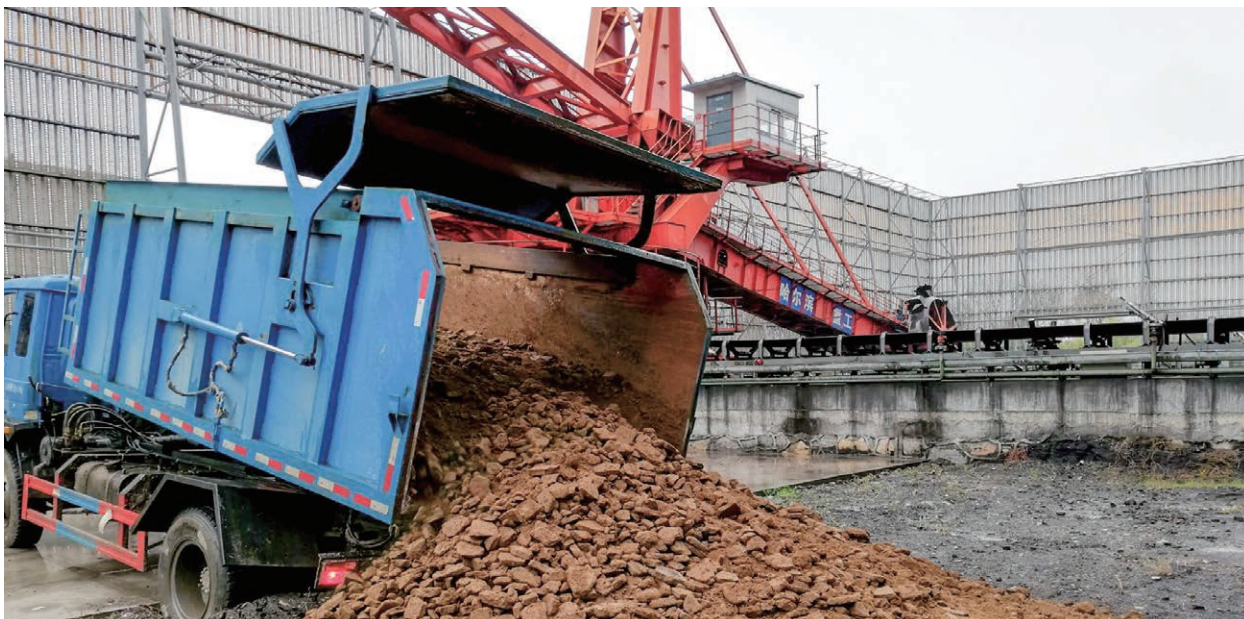
九华公司掺烧城市生活垃圾和固废现场
