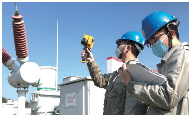
龙源电力福建平潭风电场员工开展避雷器连接点温度监测
