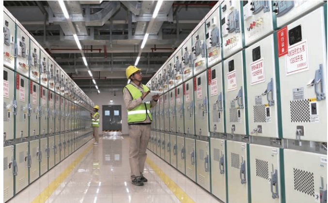
国神鸳鸯湖电厂运行人员对配电室进行巡检
